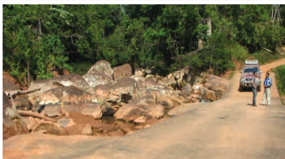
Fotografía 6.1.1 Caminos departamentales y vecinales dañados
