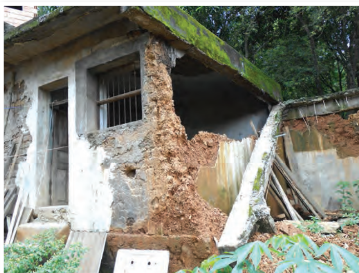
Fotografía 5.3.4 Colapso de estructura de una vivienda en el Municipio de Guanay, departamento de La Paz.
